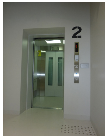
エレベーター No.3 : EV-T3-06H (2階)
