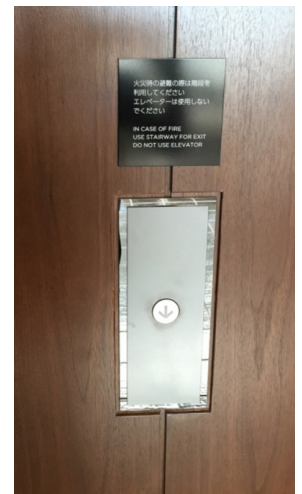
エレベーターホールボタン
