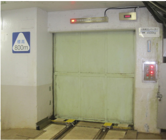
人荷用エレベーター全景 (標平上部乗場)
