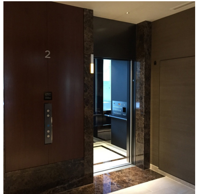
3号機エレベーター
