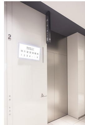
高層棟 オフィス用 H1～16号機 エレベーター サイネージモニター
