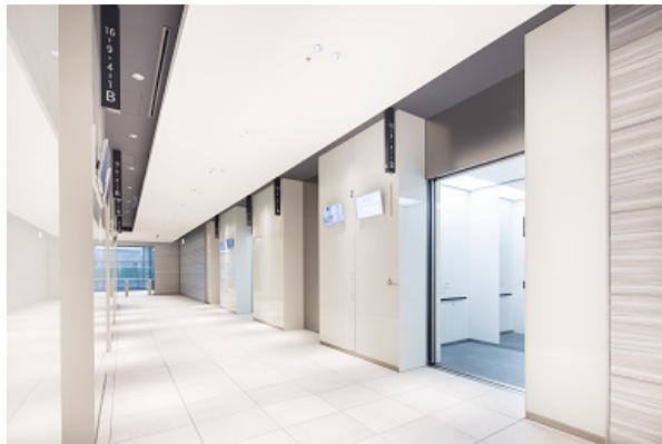
高層棟 オフィス用 H1～16号機エレベーター 2階ホール
