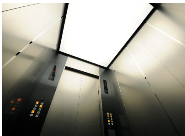
オフィス用エレベーター OM-1 ～ 8 号機 かご室
