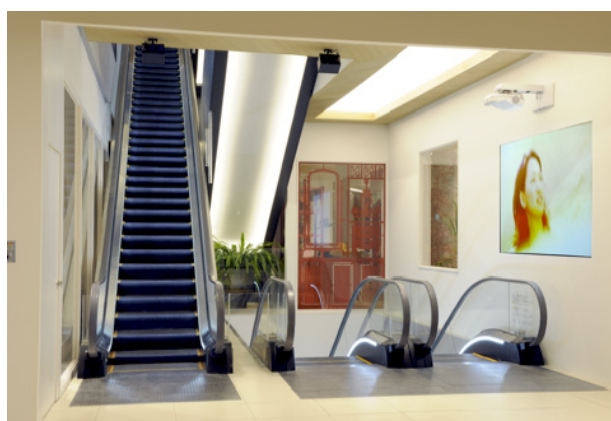
商業用エスカレーター ESC-S3 ～ 8 号機
