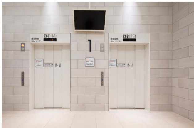
乗用エレベーター乗場
