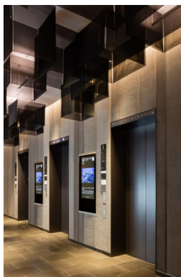
店舗用エレベーター 1階乗場
