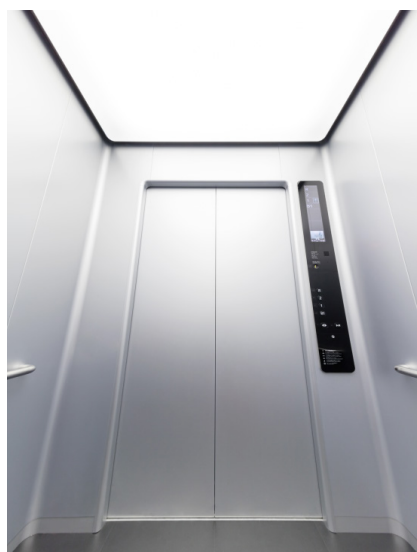
エレベーターかご内
