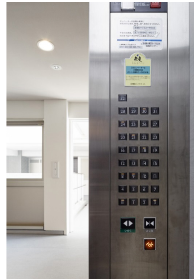
スカイタワー棟 エレベーターかご操作盤
