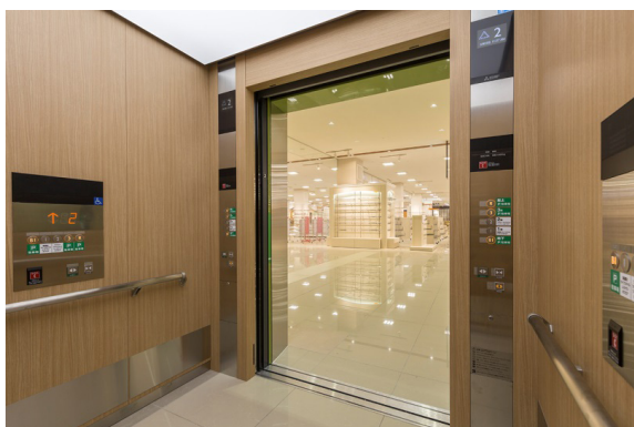
乗用エレベーター かご内
