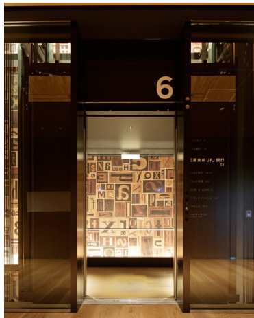
乗用エレベーター乗場
