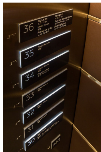
ホテル高層客用エレベーター かご内ボタン
