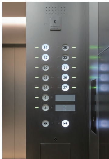
オフィス用エレベーターかご内 (行先ボタンと停止可能階を示す表示灯)
