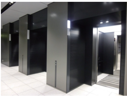
1～3号機 オフィス用エレベーター 1階エントランスホール
