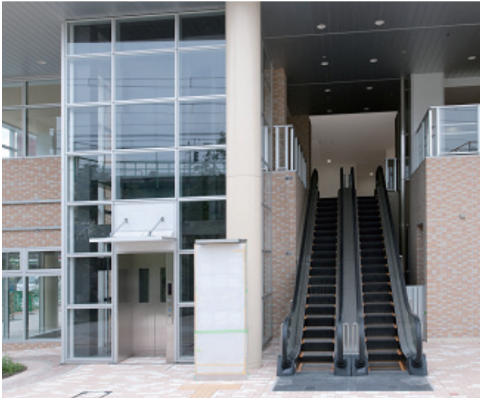
店舗用（5号機）1階乗場
