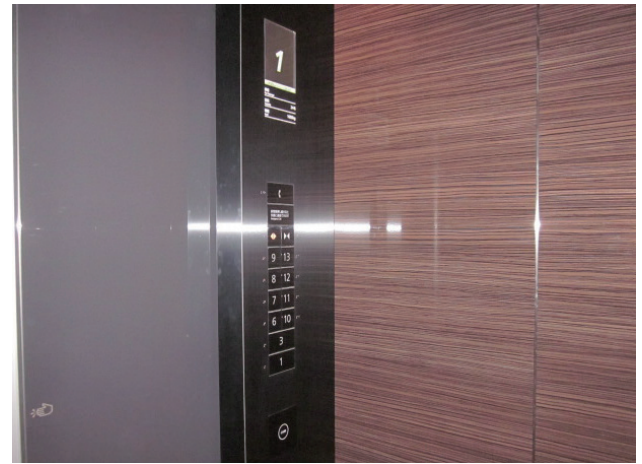
オフィス用エレベーターかご内操作盤
