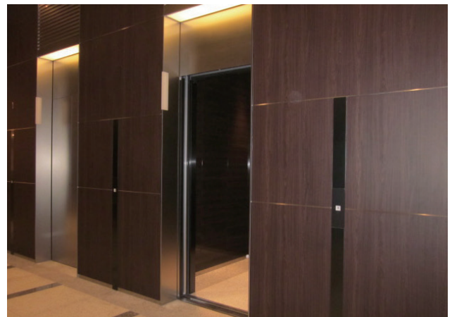
オフィス用エレベーター 1階エントランス
