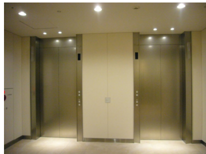
25,26号機商業部エレベーター 一般階乗場
