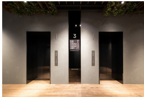
乗用エレベーター 3階乗場
