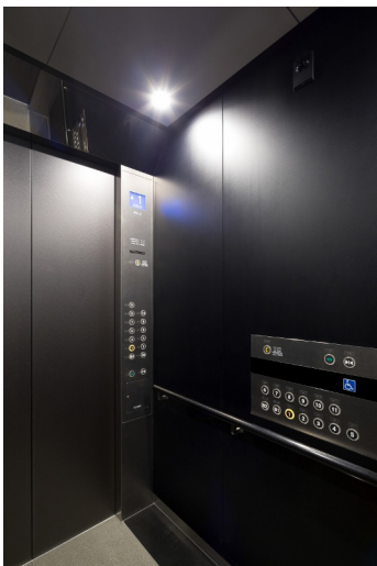
乗用エレベーター かご内
