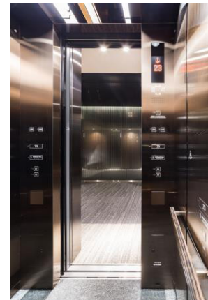
EV-17 号機 乗用エレベーター かご内
