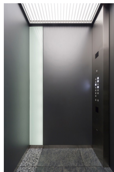
EV-1 ～ 6 号機 乗用エレベーター かご内
