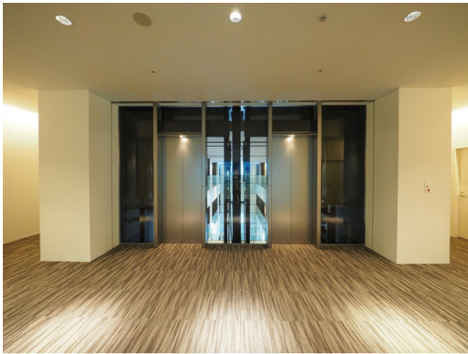
EV15、16号機 エレベーター乗場
