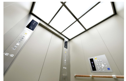
B-1～3号機 エレベーター かご内
