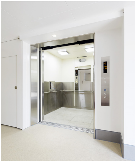
エレベーター1、2号機 M2階乗場
