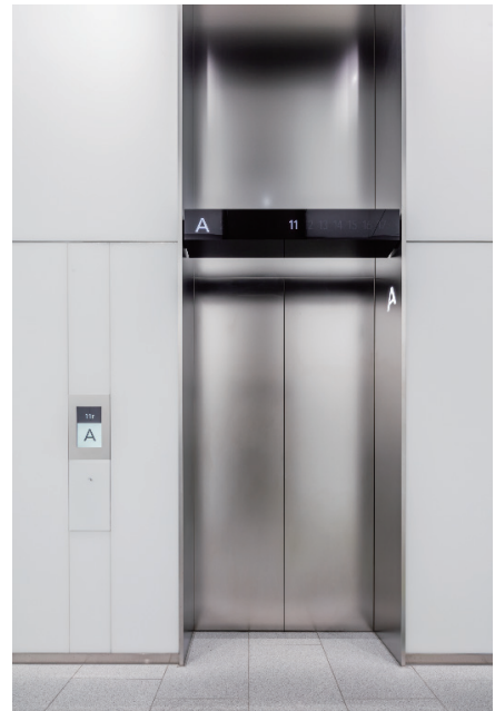
ELV4号機 1階乗場
