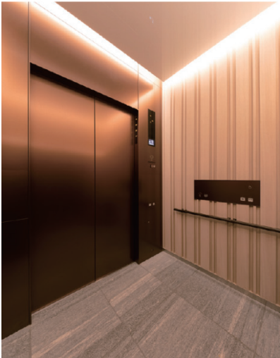
オフィス用 エレベーターかご内
