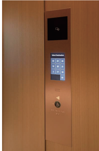
行先階登録装置 (エレベーターホール)
