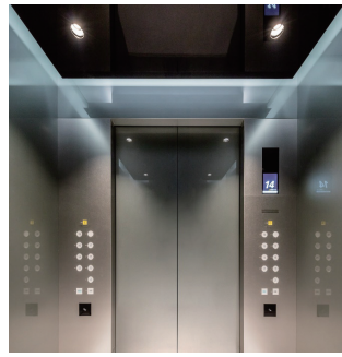
オフィス エレベーターかご内(正面)
