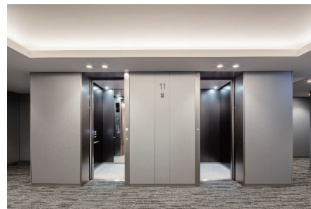
SOHOエレベーター11階乗場
