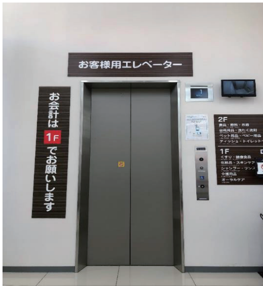
乗用エレベーター 1階乗場
