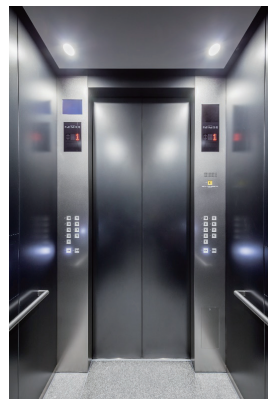
SOHOエレベーターかご内正面
