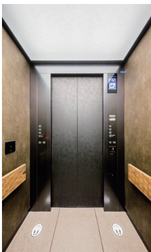
ELV21、22号機 かご内
