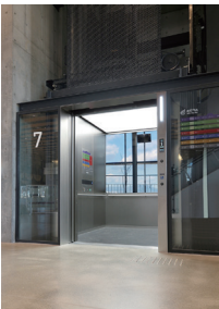
エレベーター1号機
