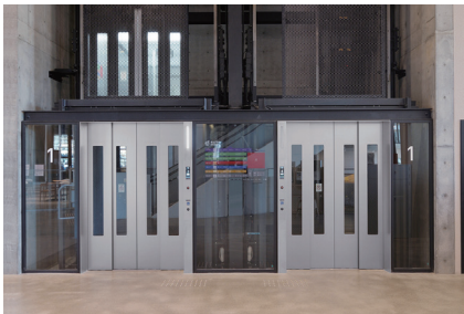
エレベーター1、2号機、1階乗り場
