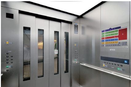
エレベーター1号機 かご内室
