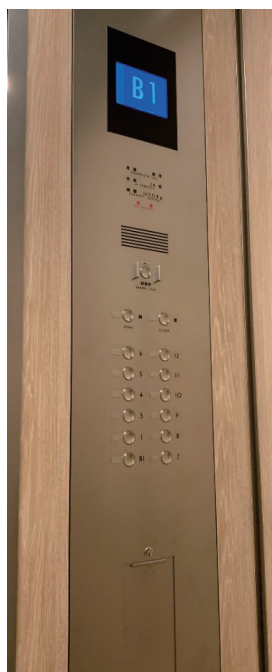
オフィス用エレベーター かご操作盤
