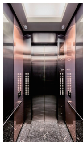
レジデンス棟EV1~4号機 かご内
