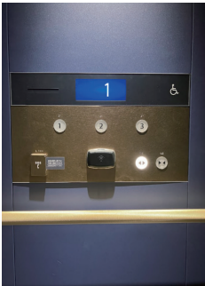
カードリーダー付き かご内操作盤
