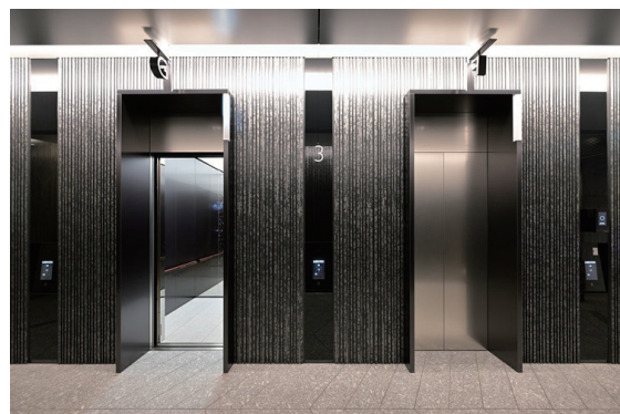
オフィス低層用エレベーター 3階エレベーターホール
