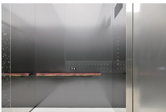
オフィス用エレベーター 車いす操作盤
