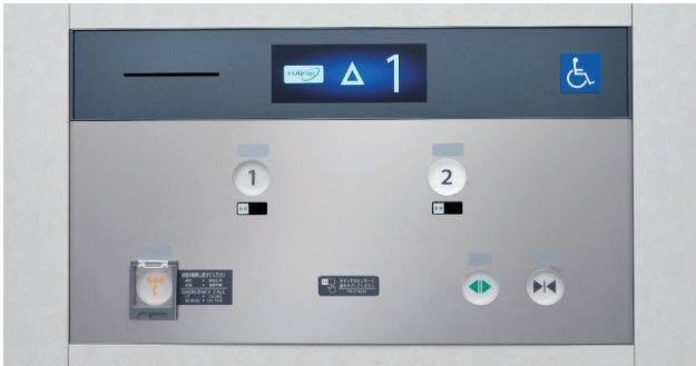
2号機 車いす操作盤
