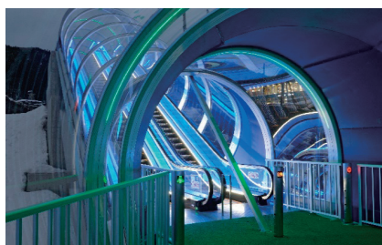
エスカレーター 3-A・B号機 (ライトアップ)
