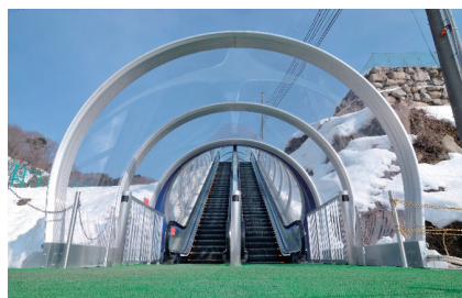
エスカレーター 1-A・B号機
