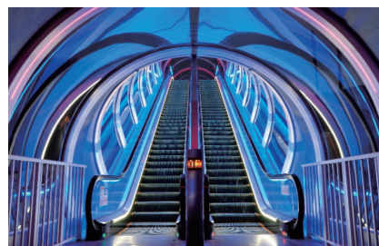
エスカレーター 1-A・B号機 (ライトアップ)
