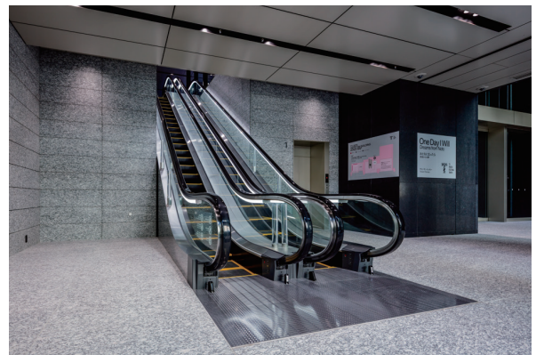
1、2号機 エスカレーター1階乗場
