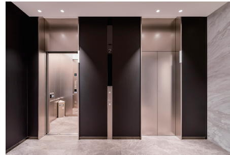
EV02-1-4号機 (オフィス北) 2階 2台
