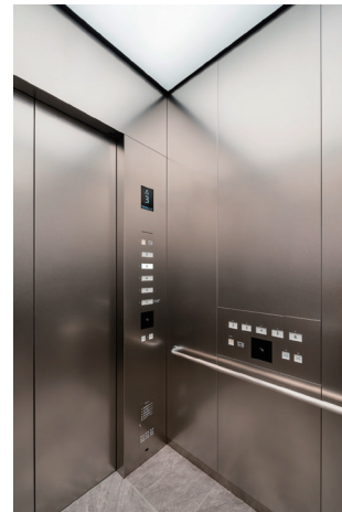
EV02-1号機 (オフィス北) かご内
