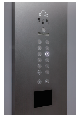
1～5号機 かご操作盤
