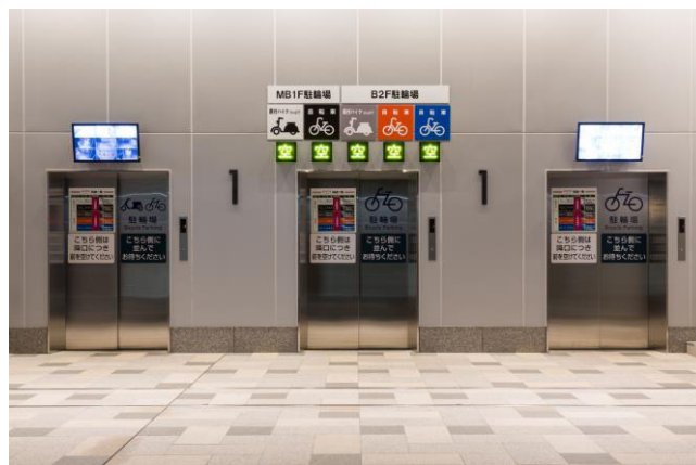
駐輪場用エレベーター乗場
