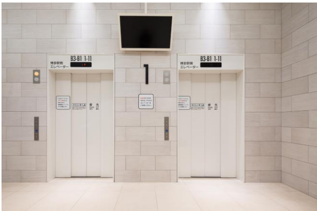
乗用エレベーター乗場
