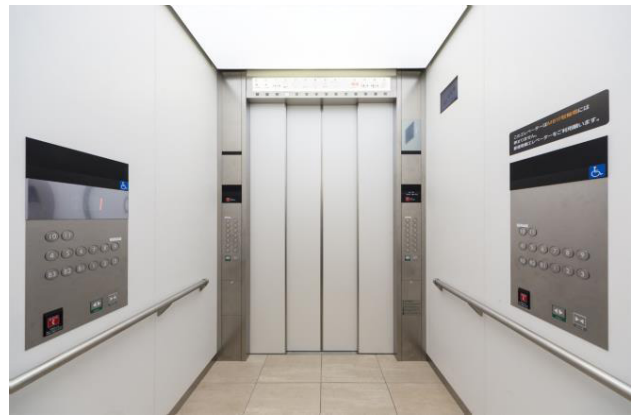
乗用エレベーターかご内
