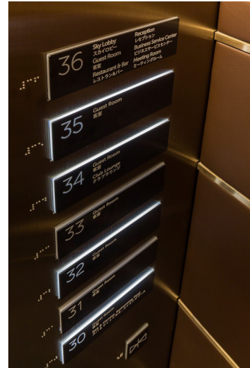
ホテル高層客用エレベーター かが内ボタン
