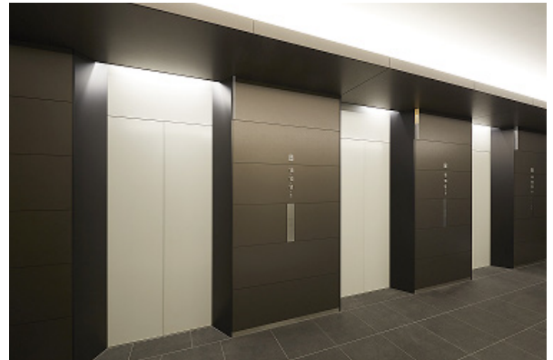
オフィスエレベーター 一般階ホール
