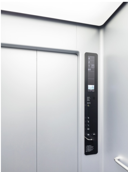
かご内操作盤
