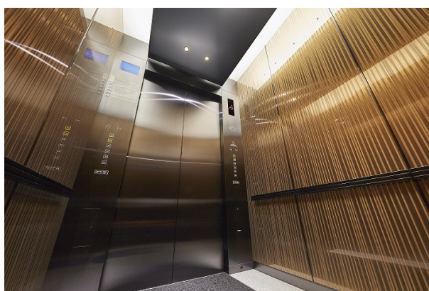
高層オフィス用エレベーター かご内
