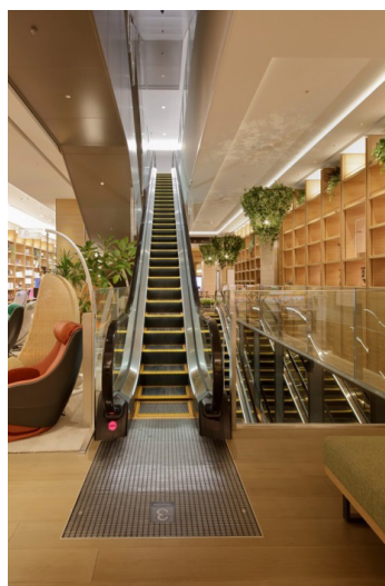
A3、B3号機 エスカレーター
