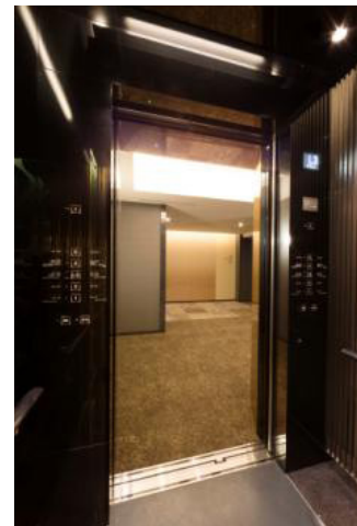
2号棟 乗用エレベーター かご内操作盤
