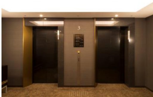
2号棟 乗用エレベーター L・3階乗場
