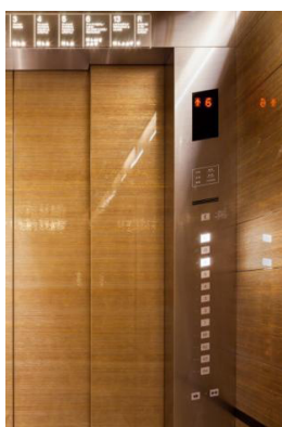
C3号機 店舗用エレベーター かご内操作盤
