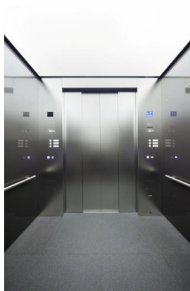
B3号機 オフィス用エレベーター かご内
