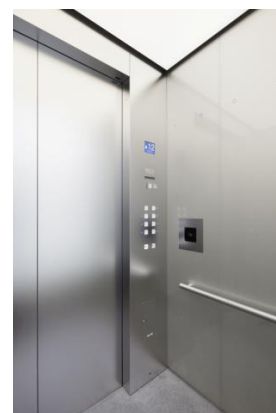
E6号機 オフィス用エレベーター かご内操作盤
