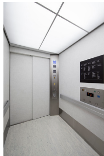
3号機乗用エレベーター かご内
