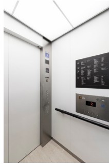
1、2号機乗用エレベーター かご内
