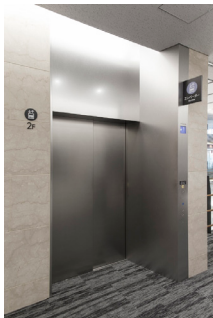
3号機乗用エレベーター 2階乗場
