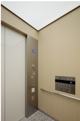
事務所用 乗用エレベーター かご内
