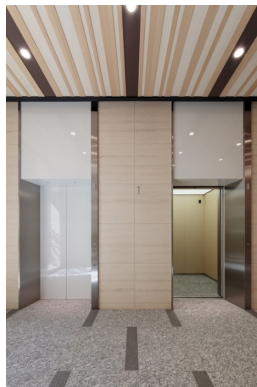
事務所用 乗用エレベーター 1階乗場
