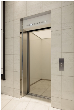
商業施設用 乗用エレベーター 1階乗場
