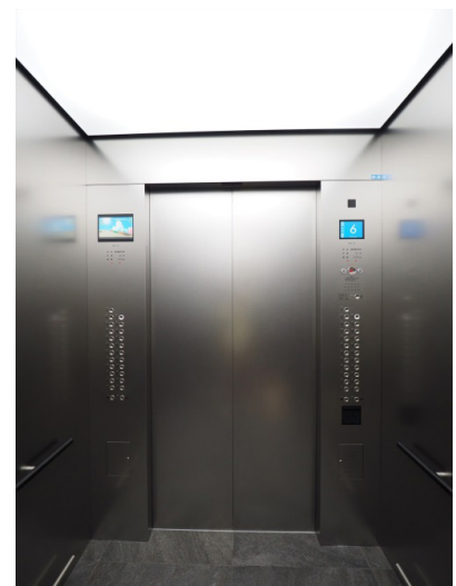
EV13号機 かご内
