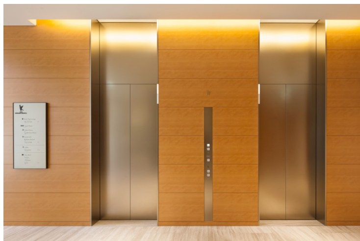
乗用エレベーター 1階乗場
