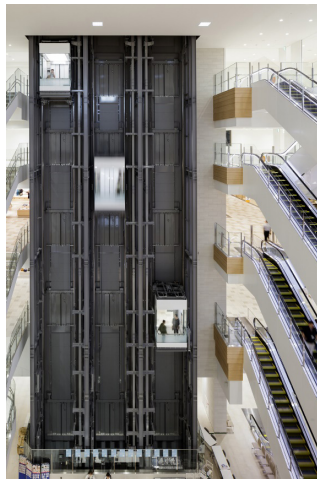
EV-1バンク 昇降路外観
