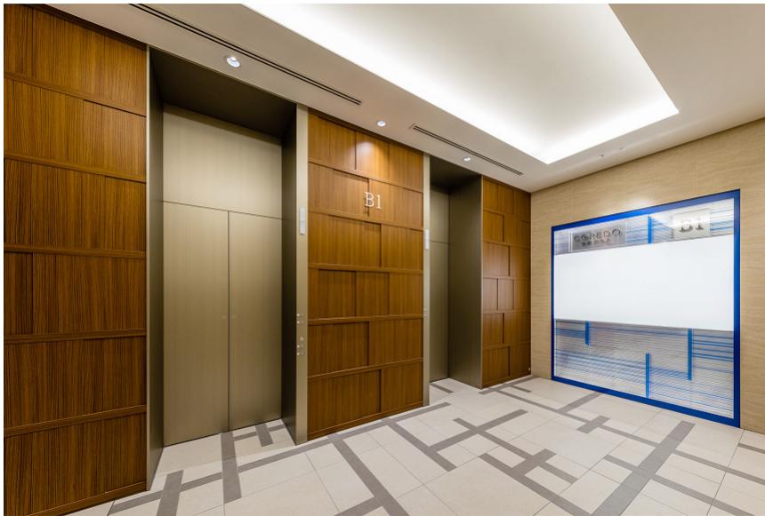
商業客用エレベーター B1階 乗場
