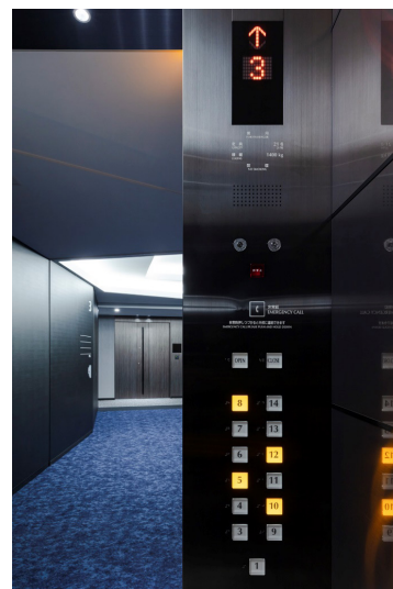
EV1号機 操作盤
