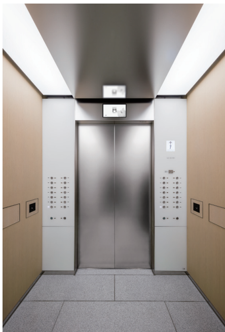
ELV2号機 かご内
