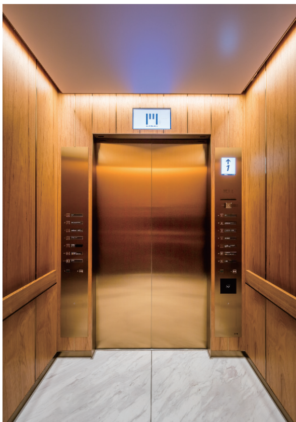
ELV28号機 かご内
