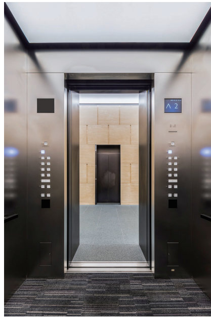
EV6,7号機 かご室
