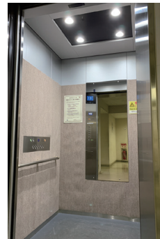
管理棟1、2号機 かが内
