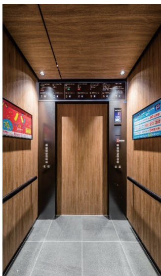
ELV1、2号機 かご内
