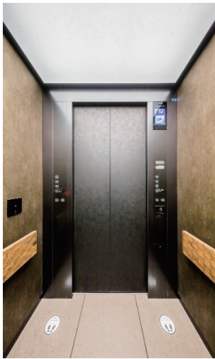
ELV21、22号機 かご内
