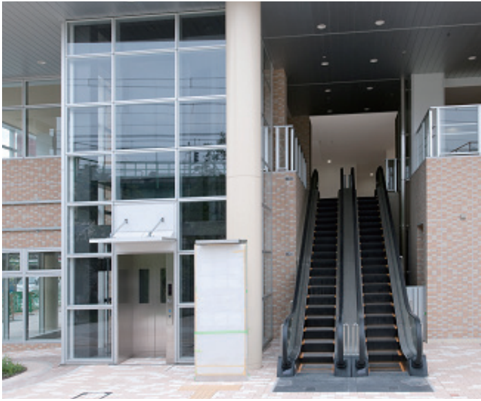
店舗用（5号機）1階乗場
