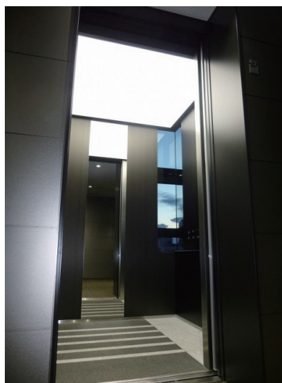
4,5号機 テナント用エレベーター かご内
