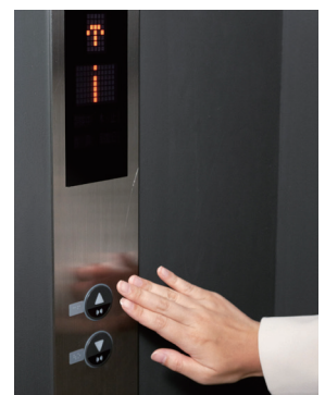
エレベーター操作盤 (No.2)
