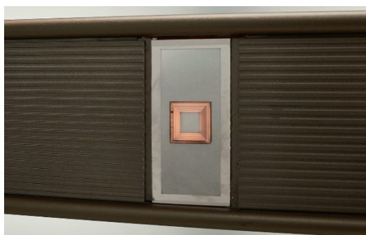
S棟中層用号機 1階 リニューアル前 乗場ボタン
