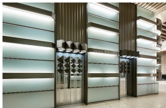
S棟高層用号機 リニューアル後 1階エレベーターホール
