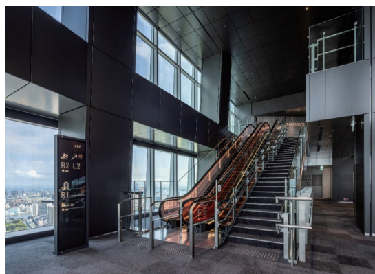
エスカレーター 24,25号機 45階アライバルホール（下部乗降口）
