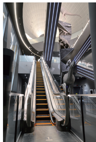
エスカレーター 2 号機
