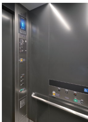
エレベーター 5 号機
