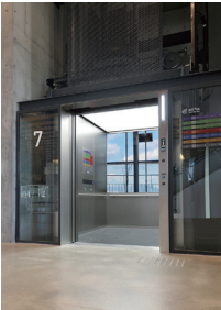
エレベーター1号機
