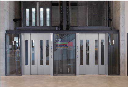
エレベーター1、2号機、1階乗り場
