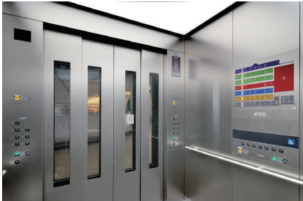
エレベーター1号機 かご内室
