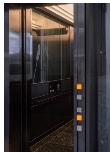
スクエア内エレベーター 乗場押ボタン
