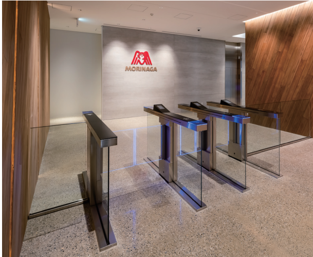
エレベーターホール前に設置された行先階登録システム 1階
