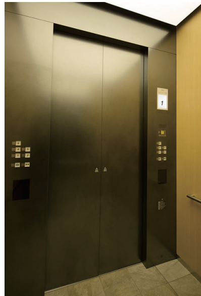
S-EV2 ~ 4号機 オフィス用エレベーター かご内
