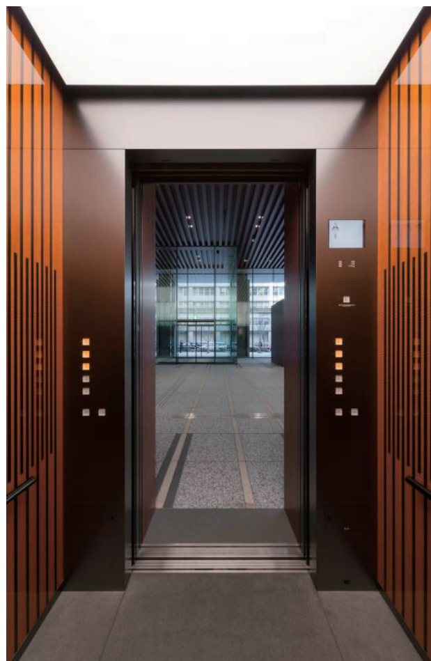
活性化用途客用エレベーターかご内
