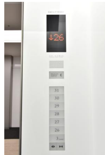
A～Dバンク オフィス用エレベーター かご内操作盤
